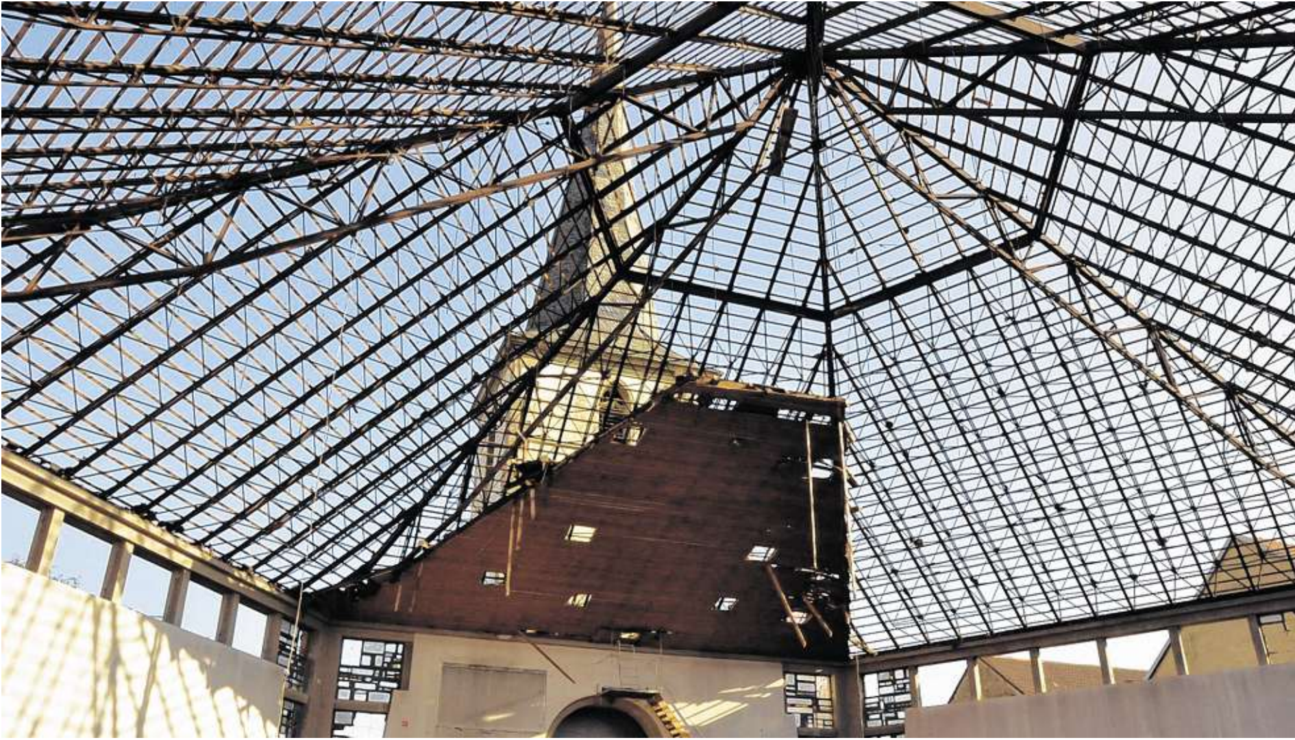
Offener Blick in den Himmel: die Stahlkonstruktion des Dachs, ihrer Ziegel beraubt.
